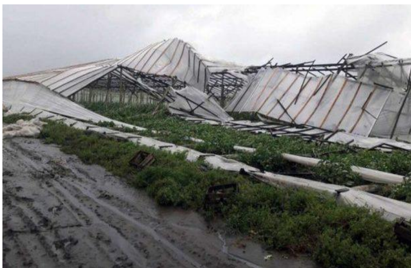
Figura 4: Destrozos de la tormenta del 2019
