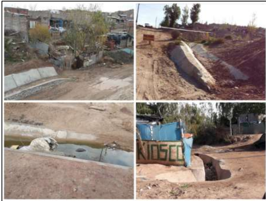
Figura 14: Estado de las obras pluvioaluvionales
